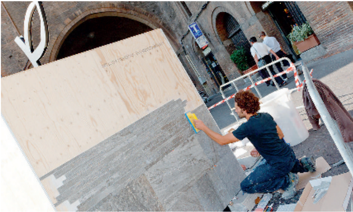
Un momento dell'installazione dei cubi di piastrelle nel centro storico di Bologna
